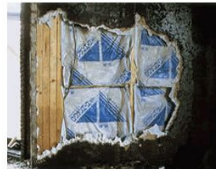
▲火災現場：ボード内部には火がまわっていない
